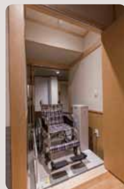
⑫小宴会場の出入口にある 段差解消機
